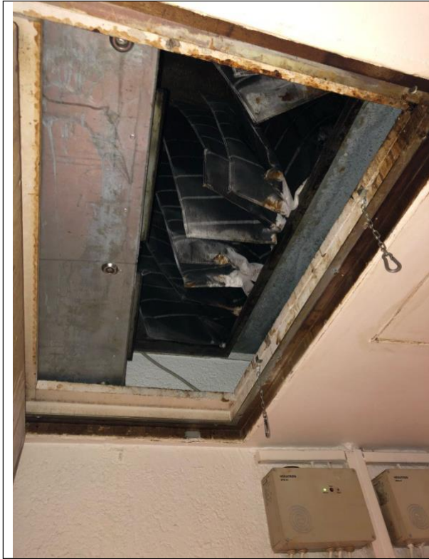
Schimbarea filtrului / inspecția canalelor 16.01.2020
